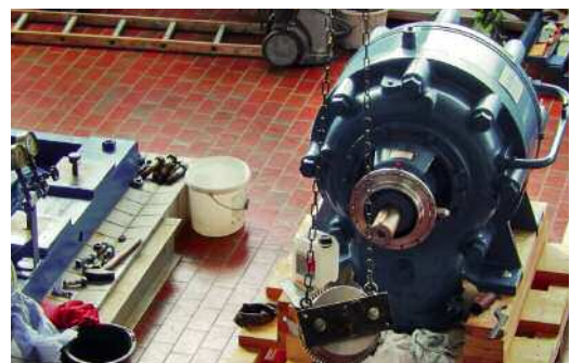
Einbau eines Pumpenmotors im Wasserwerk Ammerbuch-Poltringen nach Revision
