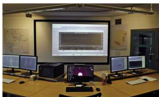
Ein Blick in die rundneuereite Leitzentrale im Wasserwerk Ammerbuch-Poltringen
